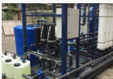
AZUD HELIX AUTOMATIC 202 AA Lavandería Guadalupe Island hotel
