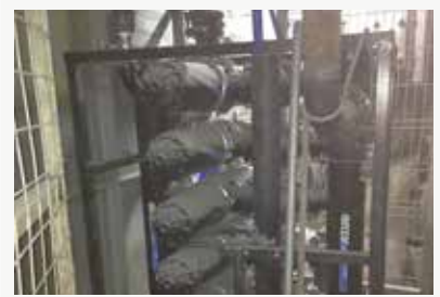
AZUD HELIX AUTOMATIC 4DCL6 Mina de cobre Codelco
