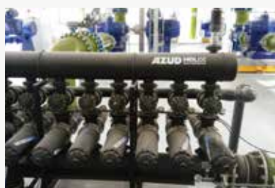
4x AZUD HELIX AUTOMATIC 4DCL9 Torres de oficinas de Westbay
