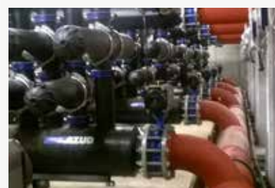
7x AZUD HELIX AUTOMATIC 4DC12 Pabellón EXPO'15 en Milán
