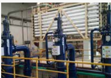
3x AZUD LUXON LDB 13200 S/14 Recuperación de agua en Shandong
