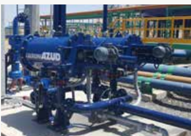
2x AZUD LUXON LXE 2700 S/4 Mina de fósforo OCP Houribga
